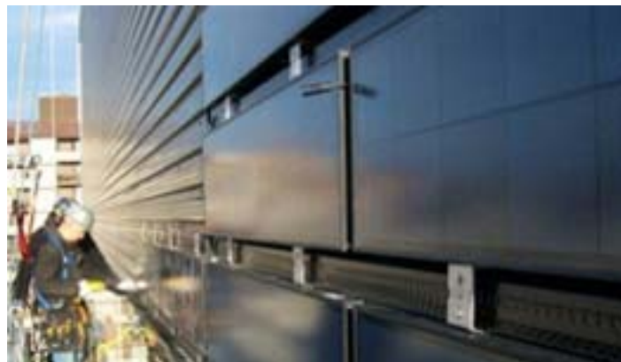
Abbildung 10: SolarWall PVT – PV-Module auf Fassade montiert (Quelle: Conserval Engineering Inc.)
